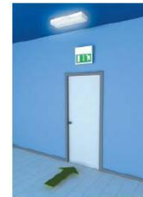
Над каждым выходом, используемым в качестве аварийного
