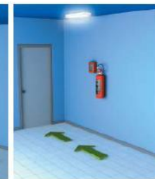
Возле каждой пожарной кнопки и огнетушителя.....
