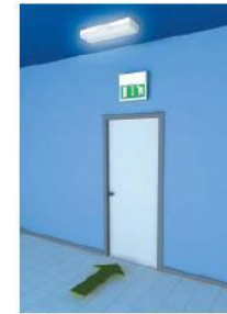
Над каждым выходом, используемым в качестве аварийного
